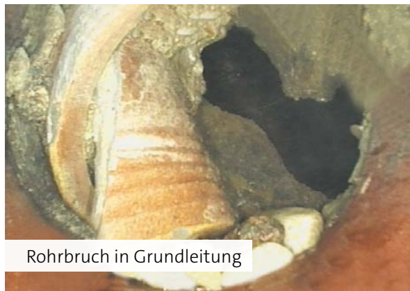
Grundleitung mit Rissen
