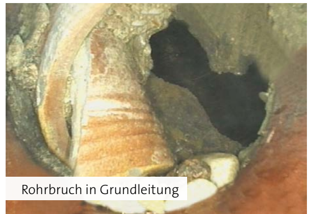
Grundleitung mit Rissen
